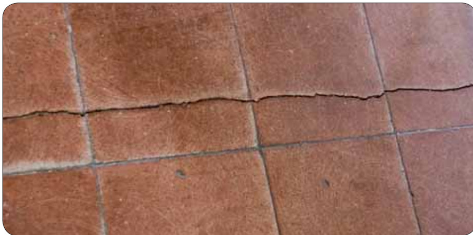
Riss im Kirchenboden
